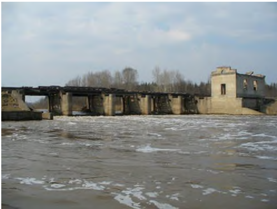
Разрушенная плотина Октябрьской ГЭС на реке Чепце у села Полом
